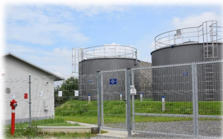
Zdjęcie nr 14. Nowa Stacja Uzdatniania Wody w Górze Ropczyckiej
